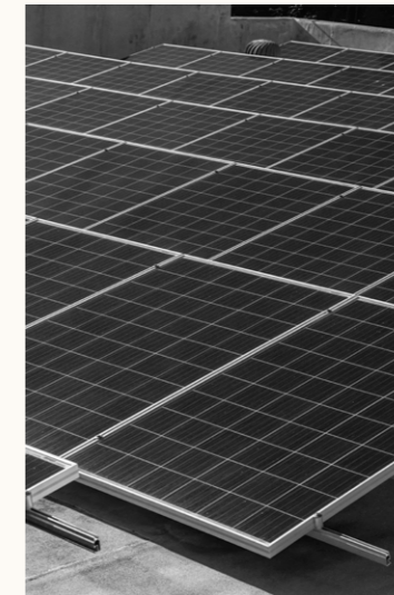
▲ Instalaciones de placas solares
